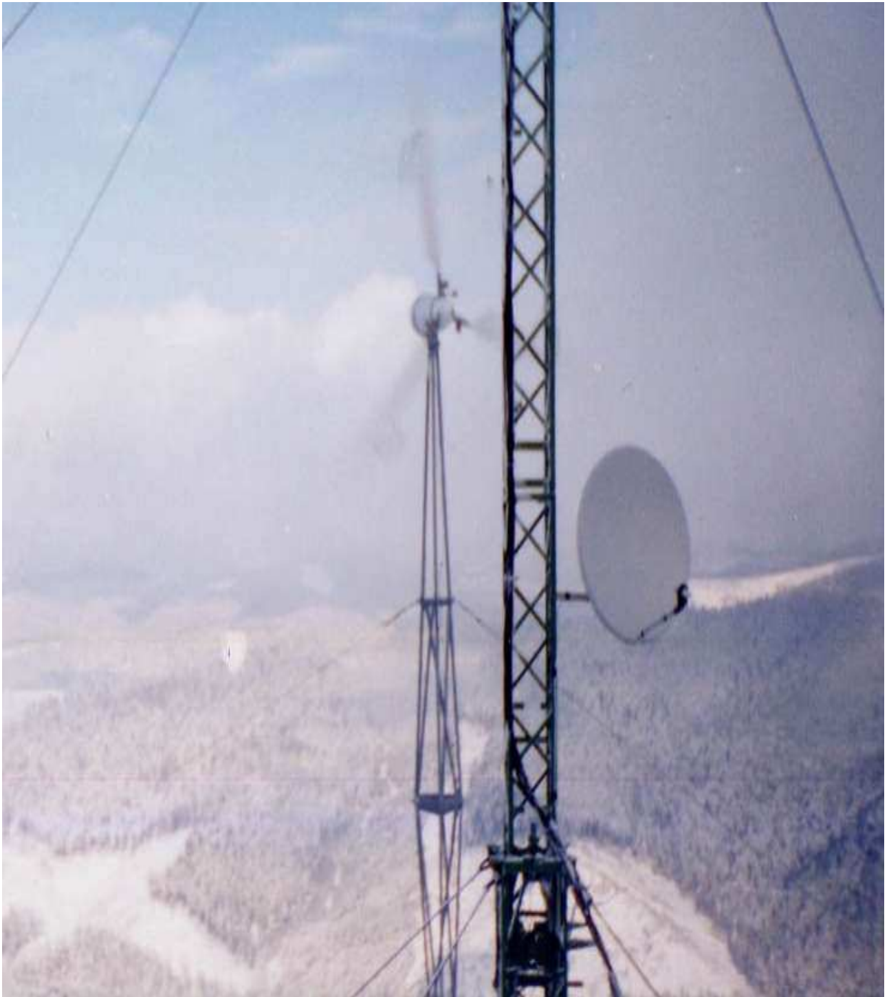
Рис. 9. Показан пример размещения ВЭУ-08 в горной местности на безлесной вершине горы Мегура горного хребта Карпат. Здесь ВЭУ-08 работает автономно и обеспечивает электрическое питание базовой станции сотовой связи. Размытость лопастей, которую видим на фото, свидетельствует о работе ВЭУ.
